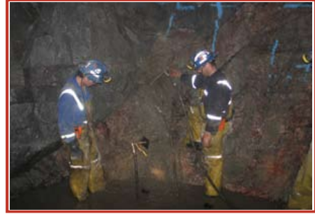
Rio Tinto, Mina de Diamante Diavik, Canadá Antes de las operaciones de excavación de minas subterráneas, se utilizaron métodos de inyección de cemento para rellenar fracturas saturadas de agua y reducir el potencial de infiltraciones de agua subterránea de alto volumen.
