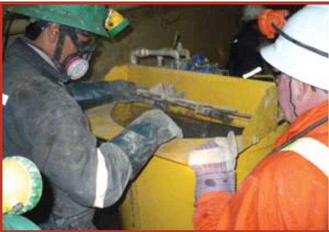
Pan American Silver, Proyecto Huaron, Perú Se utilizaron lechadas de cemento para reducir infiltraciones de agua de alto volumen en condiciones de suelo fracturado y saturado de agua antes de la construcción del pozo, utilizando métodos convencionales de profundización.
