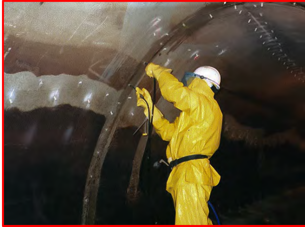
Les fissures et les joints de construction dans les structures en béton sont convenablement nettoyés avec le 'CRACK FLUSHING AGENT' avant l'injection de polyuréthane
