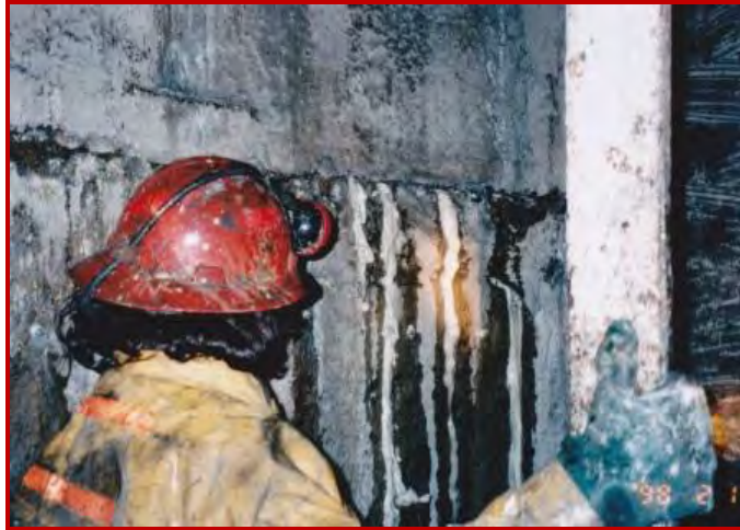
La résine 'MME UNIVERSAL RESIN' est utilisée pour arrêter les entrées d'eau à travers les joints de construction en béton qui fuient dans un puits de mine souterrain.
